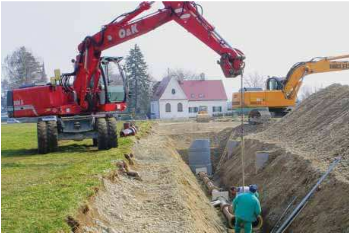
Im März 2007 wurde im künftigen Baugebiet 110, zwischen Gartenstraße und Römerallee, unter anderem diese Abwasserleitung verlegt. Für solche Investitionen müssen alle Grundstücksbesitzer Herstellungsbeiträge zahlen. Foto: Stadt Königsbrunn
